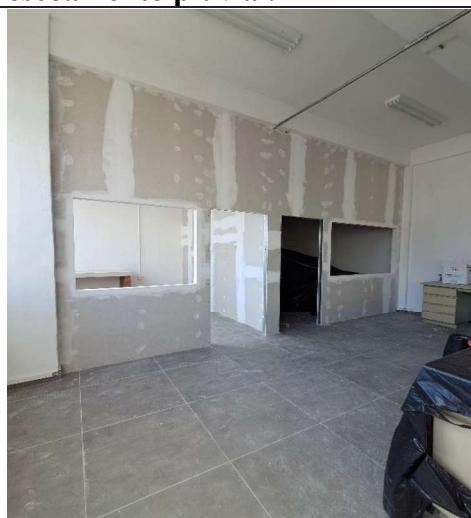
Prédio 5 – reforma do 4º pavimento, danificado pelas infiltrações da cobertura.
