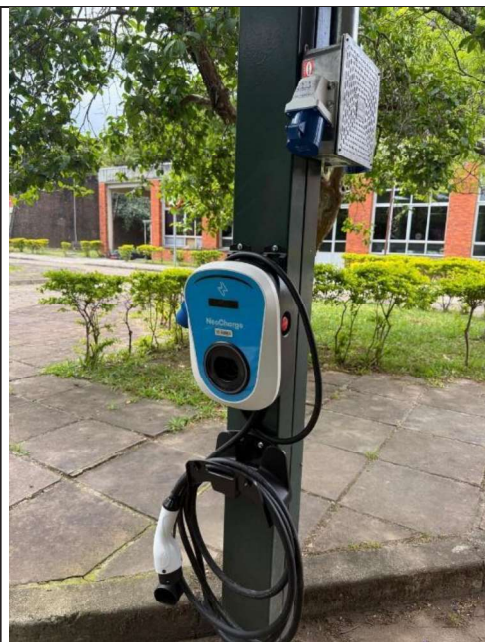
Campus Central – Estação com 4 pontos de carregamento de veículos elétricos.
